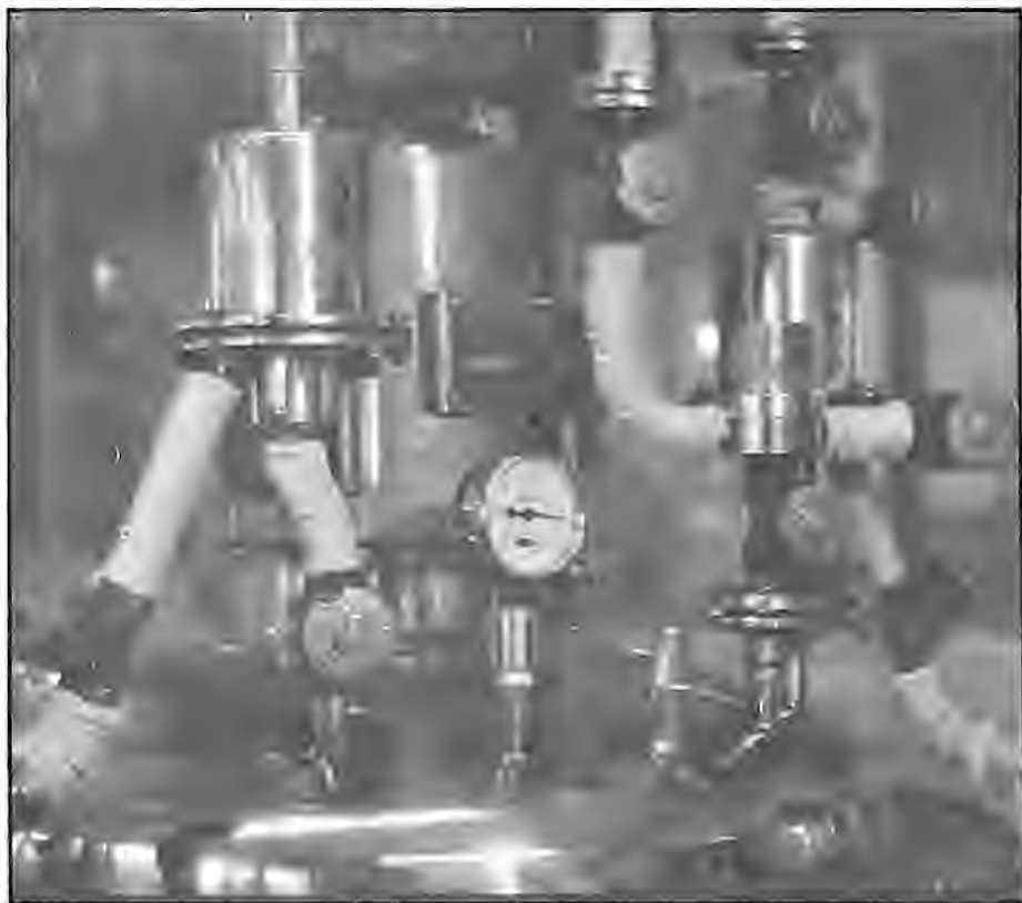
Modernos equipamentos foram instalados no CPFA.
